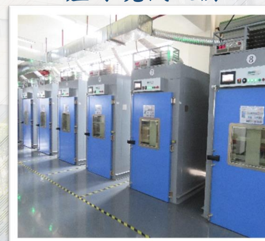
產線燒機設備
